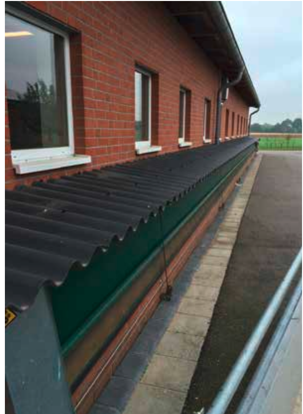
Bild 147: Zuluftöffnung zum Erdwärmetauscher
