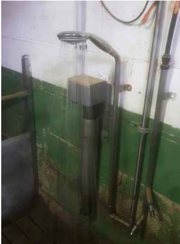
Bild 146: Schweinedusche mit Schweinebuzzer – hier setzen die Schweine die Dusche selbstständig in Gang.
