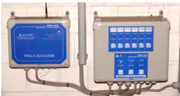
Bild 136: Alarmanlage, links Einwahl ins mobile Netz; rechts Steuerung der Lüftungsanlage
