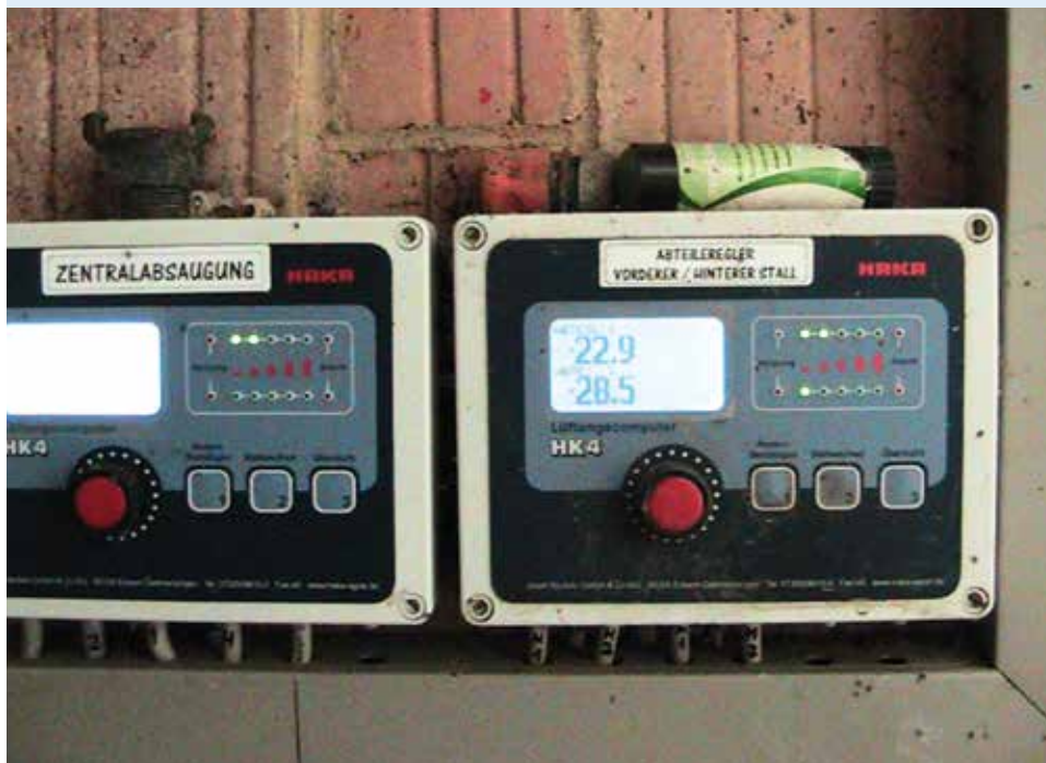
Abb. 46: Lüftungssteuerung eines Ferkel- aufzuchtstalles
