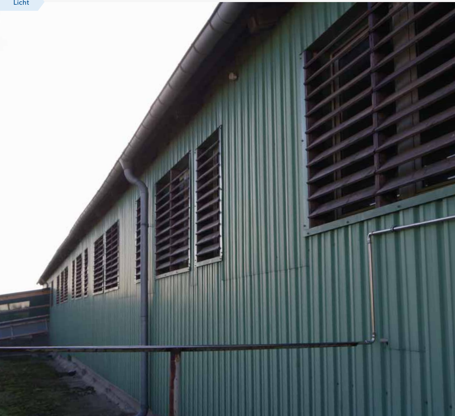
Abb. 51: Sonnenschutz an den Südfenstern
