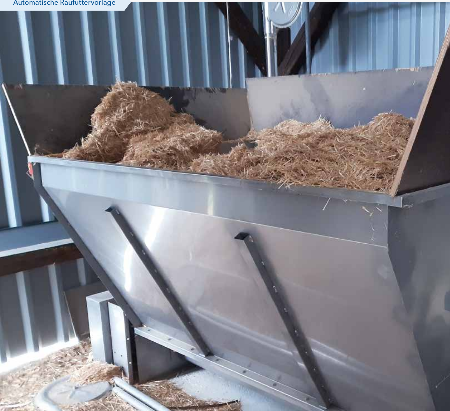
Abb. 64: Annahmebehälter einer automatisierten Raufutterfütterung
