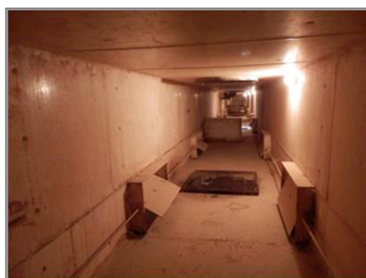
Bild 20: Blick in den Kanal einer Zentralabsaugung
