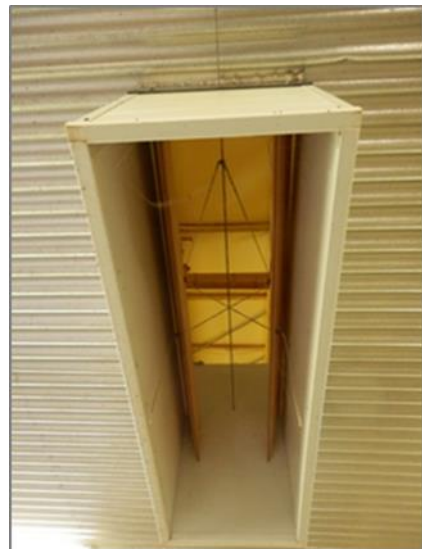
Bild 16: Deckenelement der Schlitzganglüftung mit Seilzugführung der Stellklappen für Luftmengen Anpassung
