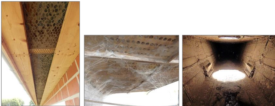
Bild 26: Verschmutzungen an Zu- und Abluftbereichen
