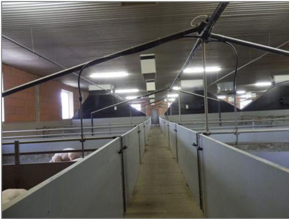
Bild 32: nicht mittig liegende Zuluftelemente der Schlitzganglüftung
