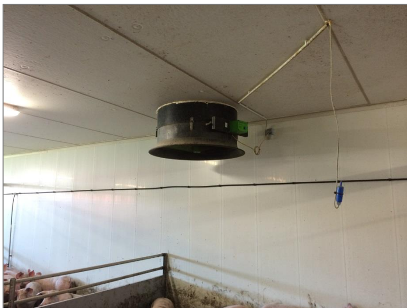
Bild 17: Abluftschacht der Oberflurabsaugung
