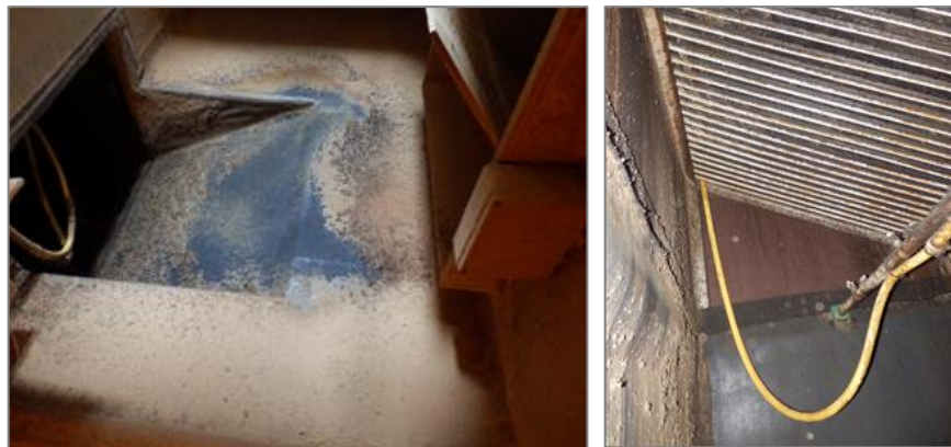
Bild 31: Luft-Luft Wärmetauscher Abluftseite
