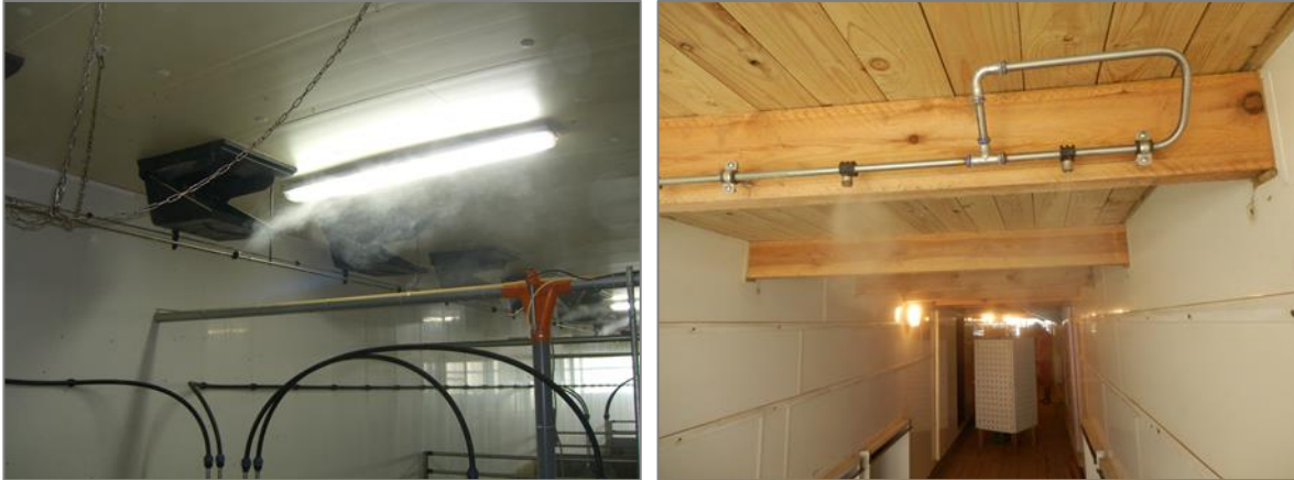
Bild 29: Wasserhochdruckvernebelung im Abteil bzw. im Zuluftbereich
