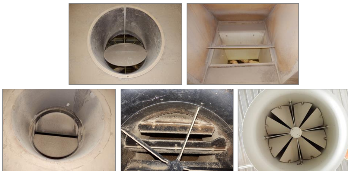
Bild 23: verschiedene Stellklappen zur Abluftmengensteuerung aus dem Abteil
