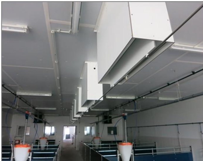
Bild 15: Deckenelemente der Schlitzganglüftung mit Mittelwand zur Luftführung und unterhalb liegender Hochdruckwasserverneblung
