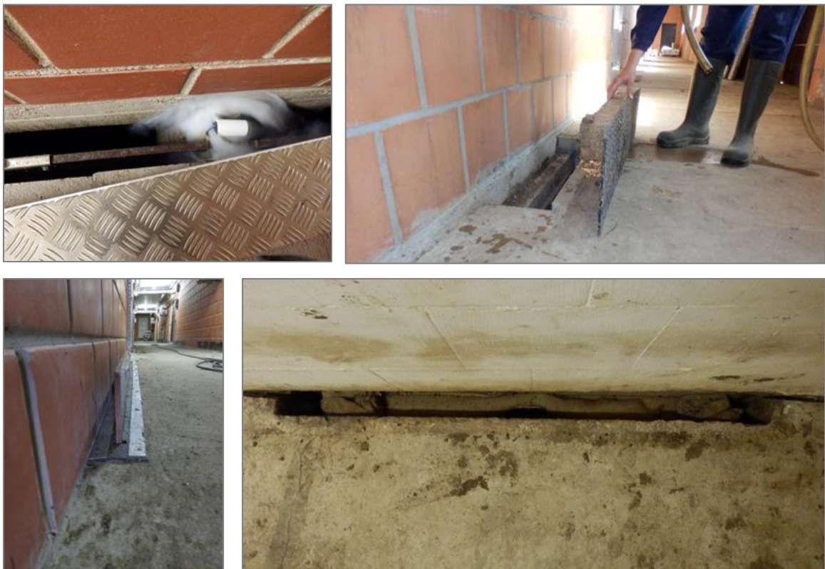
Bild 39: Verschiedene Abdichtungen von Gülleschieberöffnungen
