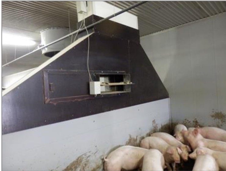
Bild 18: Unterflurabsaugung mittig im Abteil gelegen
