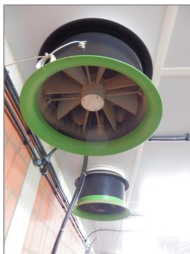
Bild 27: Abluftschacht mit Einströmdüse (hier grün)
