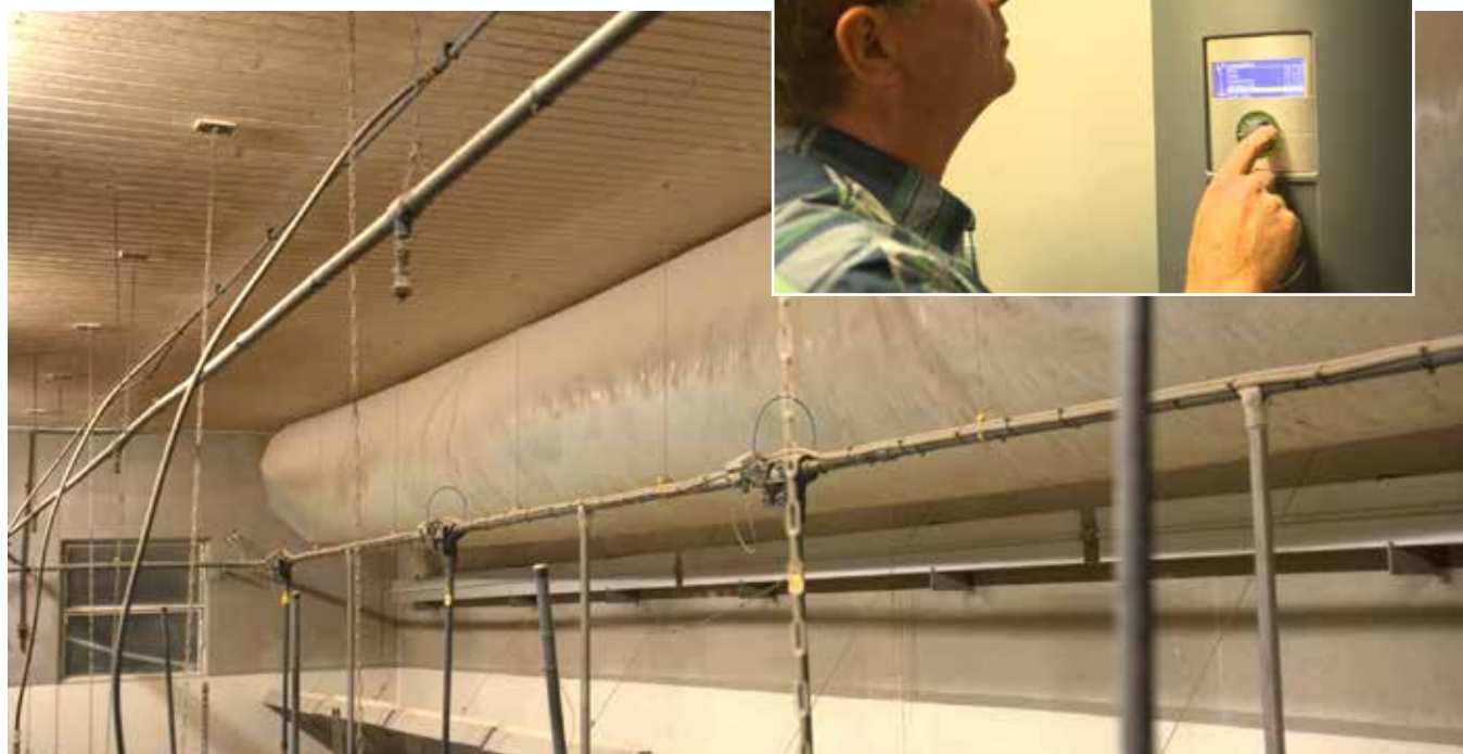
Temperatursteuerung auf dem Bauernhof von Timo Heikkilä, Finnland
